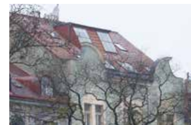
nevhodné – zde měla být jen stř. okna v PZ
