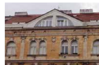
nevhodné doplnění štít. vikýře – chybný tvar otvorů v PZ
