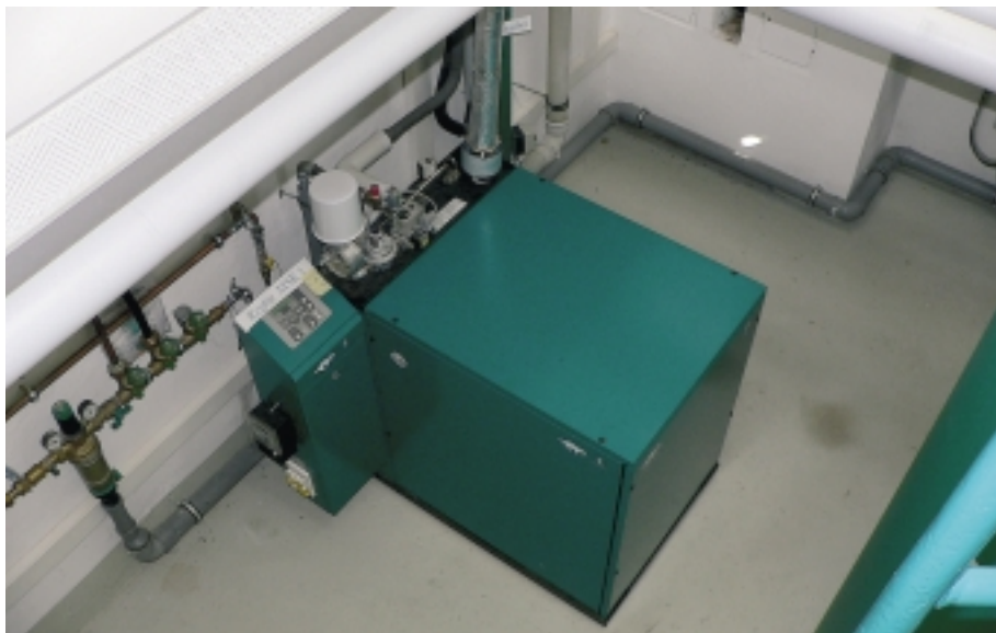
Kogenerační jednotka ve sklepě nevypadá jako složité zařízení.
