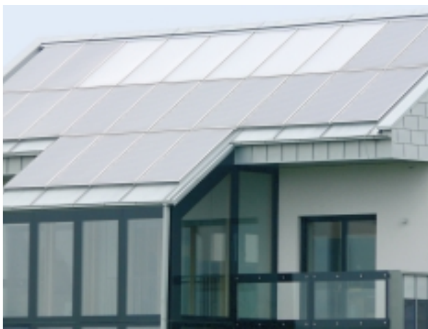
Fotovoltaické panely (tmavší) a solární systém pro ohřev vody.
