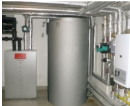
Kotelna s tepelným čerpadlem, zásobníkem TV a plynovými kotli jako bivalentním zdrojem tepla.
