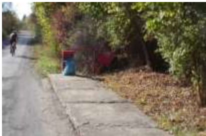
➤ Zcela nevyhovující stavební stav zastávky.
