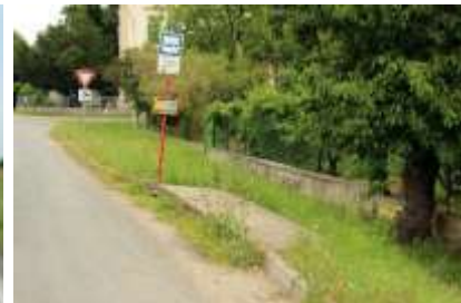
➤ Zcela nevyhovující stavební stav zastávky [Milčice, křižovatka].
