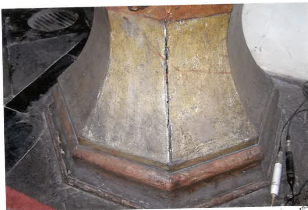
foto č. 6-stav spodní části
